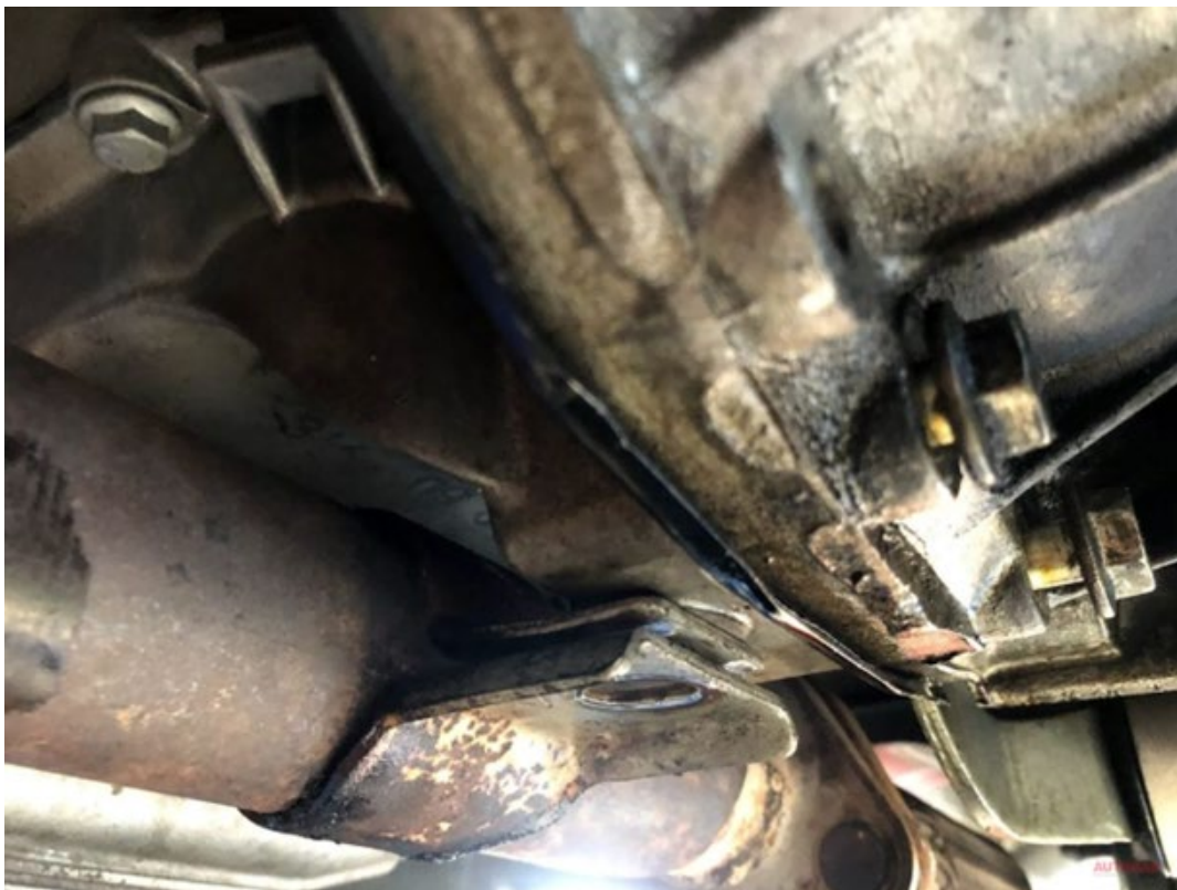
写真 16 Oil leak オイル漏れ
